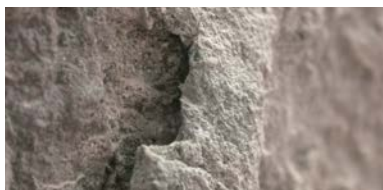
土質類古物泥土層開裂剝落
