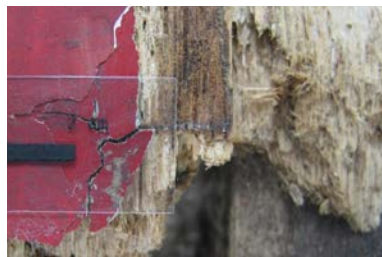
木質類古物黴腐
